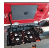
Compartiment des batteries
